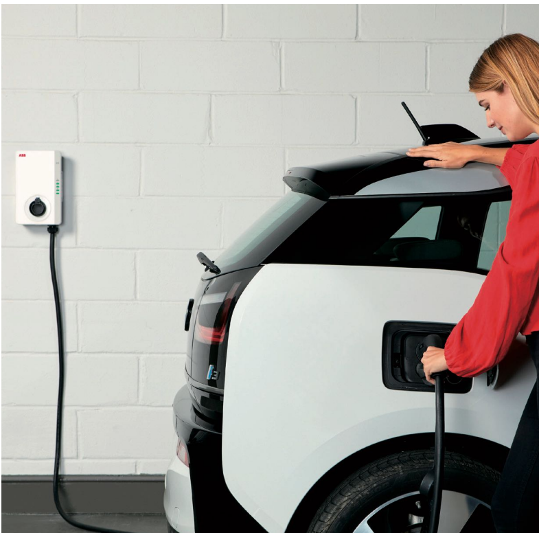
Bild 3: Ladeeinrichtung in einer Garage
