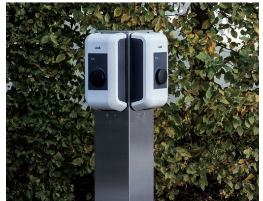
Bild 11: Ladeeinrichtung im Außenbereich
